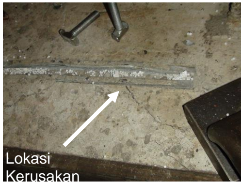
Gambar 10. Model Kerusakan U-Angkur Tertanam Dalam Beton
