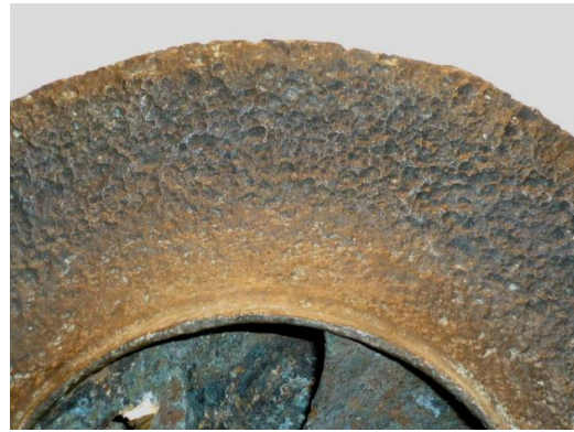
Gambar 5. Permukaan Sudu Impeller Pompa Mengalami Korosi Piting secara Merata di Bagian Luar maupun Dalam
