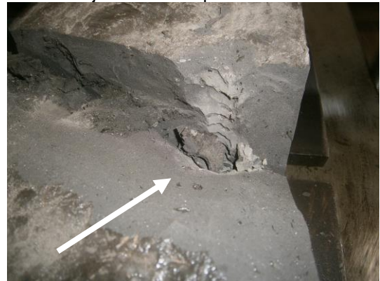
Gambar 5. Foto Kerusakan Bantalan Sintetik
