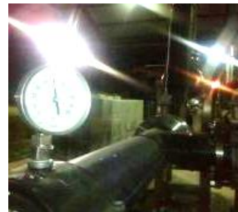
Gambar 3. Temperatur biogas sebelum unit Dehumidifier sebesar 48°C
