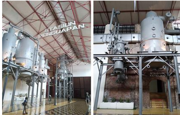
Gambar 5. Instalasi komponen peralatan di Stasiun Penguapan dan Stasiun Ketelan. (Sumber: Dokumentasi penulis, 2020)
