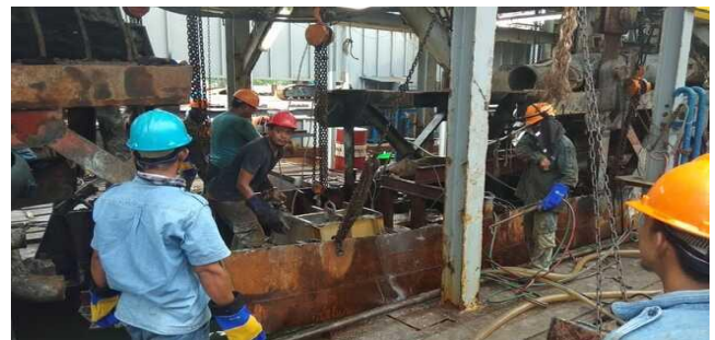
Gambar 5. Upaya perbaikan sementara ladder KIP Timah 19
