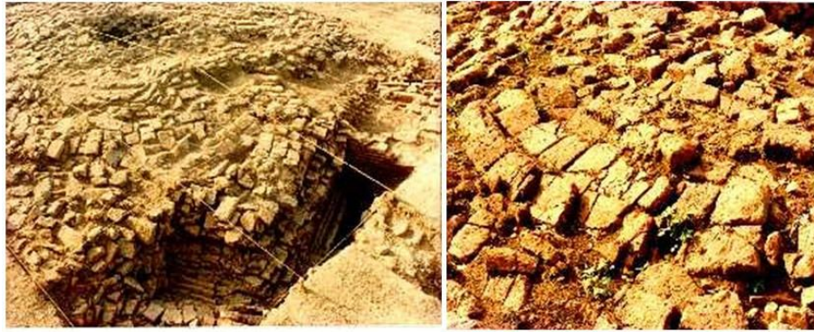
Foto 9. Bagian atas kaki Candi Telagajaya V yang menyisakan struktur bata berbentuk melingkar, merupakan bagian bawah bangunan stūpa (kiri); Detil bagian atas kaki Candi Telagajaya V (kanan) (Sumber: Hasan Djafar 1989)
