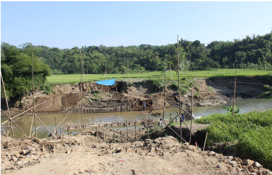
Foto 1. Jembatan Sungai Cemoro yang baru dibangun untuk menghubungkan Desa Krikilan, Kab. Sragen dan Desa Dayu, Kabupaten Karangnyar (Sumber: Pusat Arkeologi Nasional)
